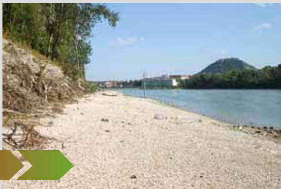
Pilot projekt Thurnhausen – revitalizirana obala rijeke nakon građevinskih radova. Projekt je dobio nagradu za Najbolji prirodni projekt Life 2007.-2008.
